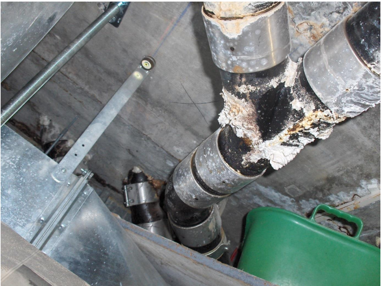
Ausblühung Leitung infolge Wasserrohrbruch
