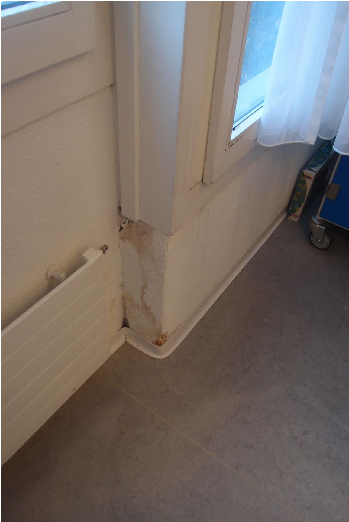
Undichte Aussenfassade, Feuchtigkeit im Innenraum
