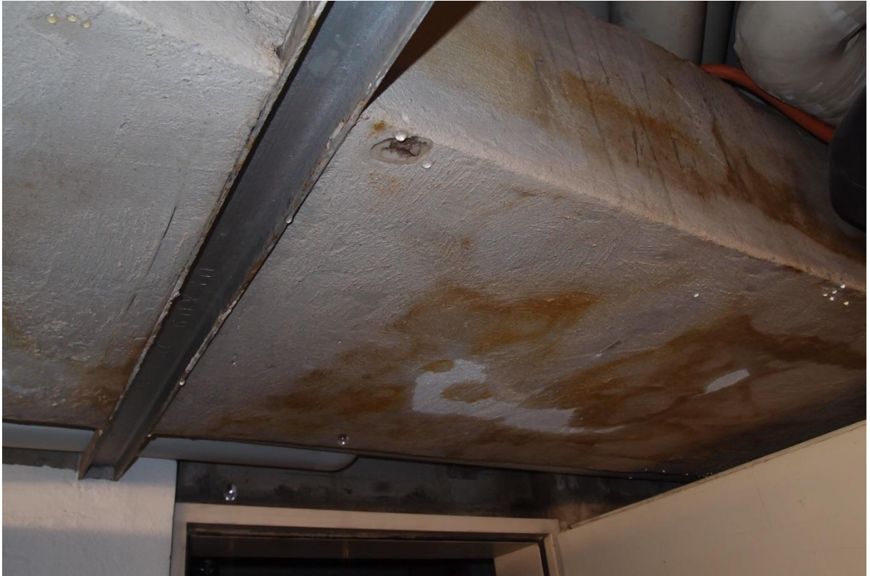
Wasseraustritt im Keller
